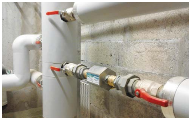
Edya Fluid' se positionne sur le réseau fermé de chauffage, l'installation pouvant être remplie à l'eau brute ou adoucie.
